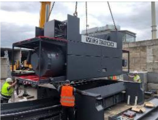
Bild 5: Für die Anlagenerweiterung installierte Vecoplan einen zusätzlichen Einwellen-Vorzerkleinerer der Baureihe VEZ 3200, der das Material kleiner 250 Millimeter schreddert.
