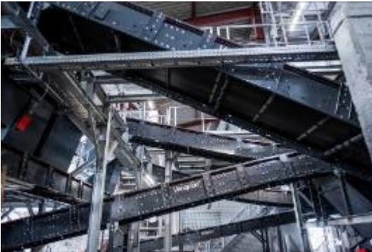
Bild 4: Vecoplan lieferte die gesamte Fördertechnik: Muldenförderbänder, Pendelverteiler, Kratzkettenförderer und Doppelförderschnecke.
